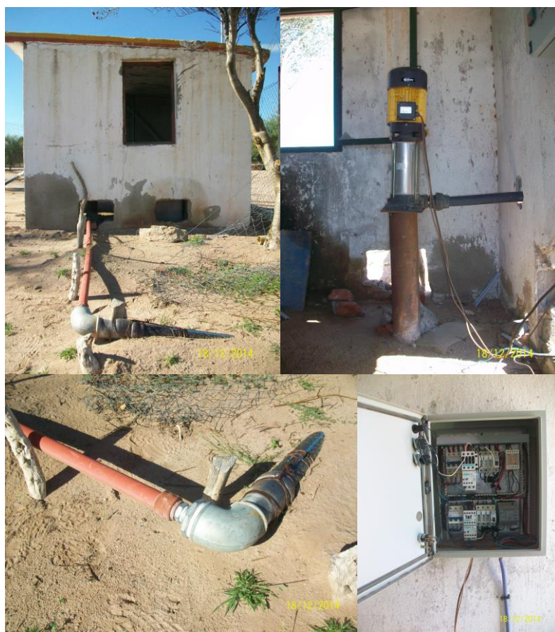
Figura 8.1.3-3: Casilla de bombeo que da inicio al acueducto La Paz - La Detención. Departamento Rosario Vera Peñaloza, provincia de La Rioja.
