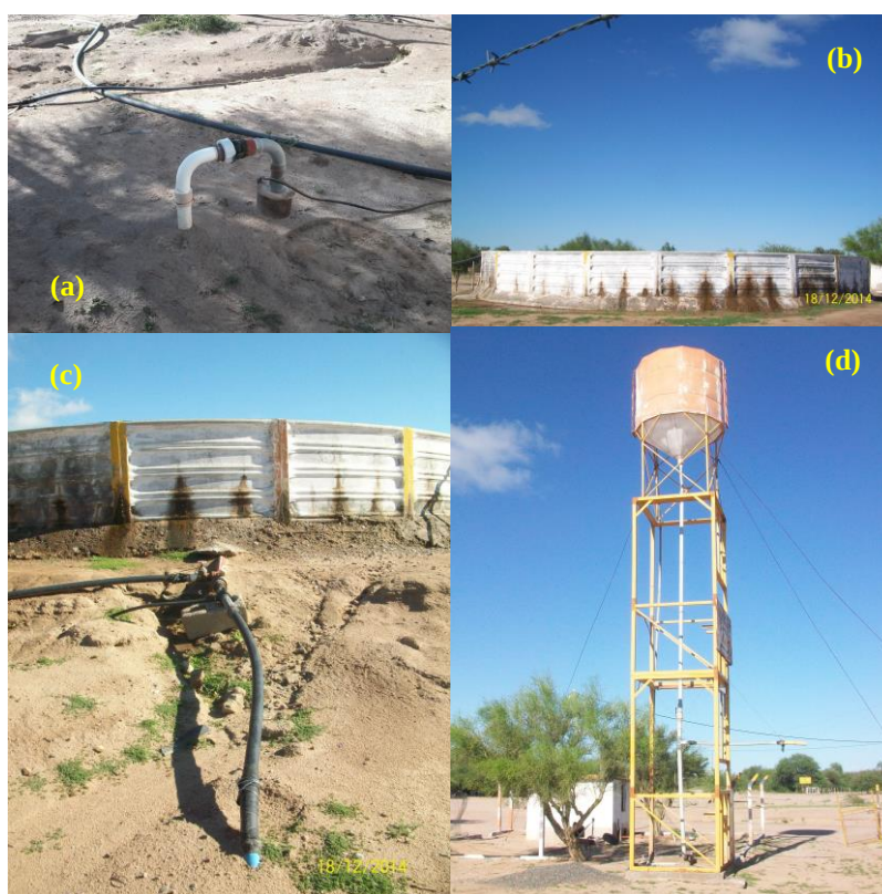
Figura 8.1.3-1: Detalle (a) perforación N° 1, (b) y (c) tanque australiano 150 m 3 y (d) tanque elevado 10 m 3 comunidad de La Paz, departamento Rosario Vera Peñaloza, provincia de La Rioja.
