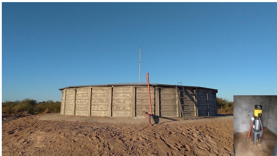
Figura 3: Nuevo Tanque de acopio 100 m 3 Estación de re-bombeo San Nicolás con tapa metálica y detalle de equipo de bombeo dispuesto.
